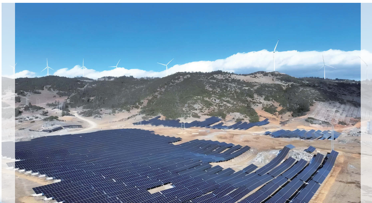
凉山州盐源县一碗水村光伏电站
